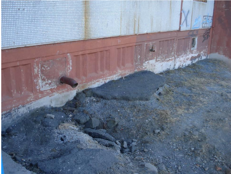
На снимке зафиксировано техническое состояние отмостки по периметру здания
