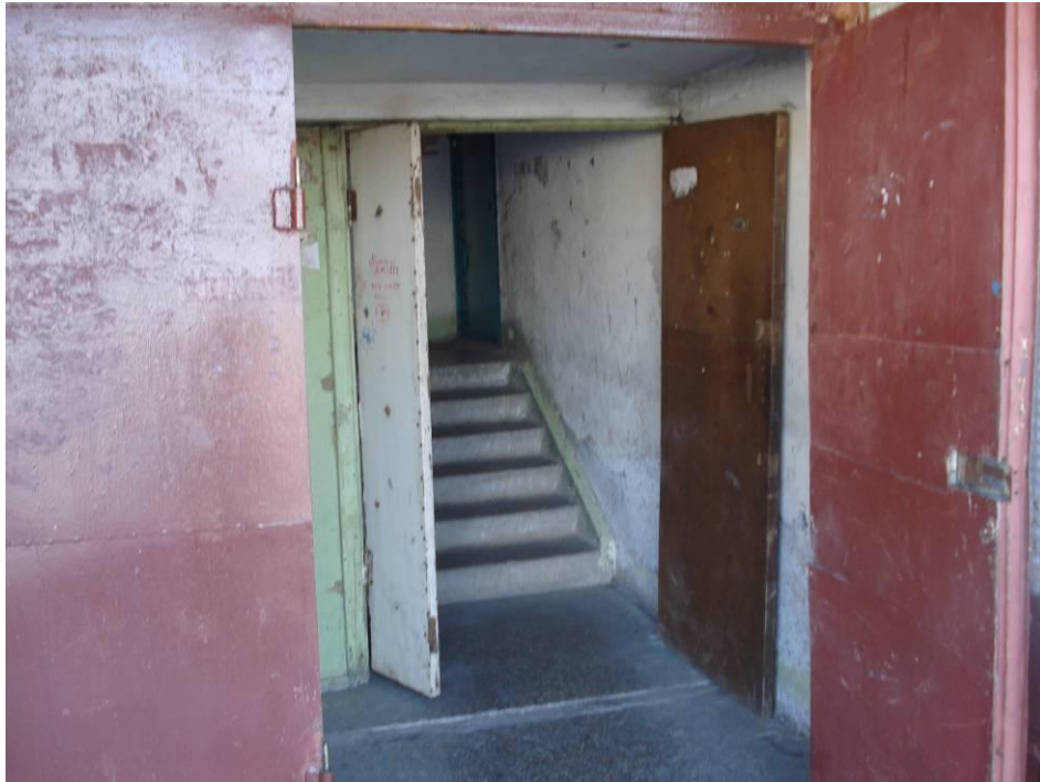
На снимке зафиксировано техническое состояние дверных блоков входа в подъезд
