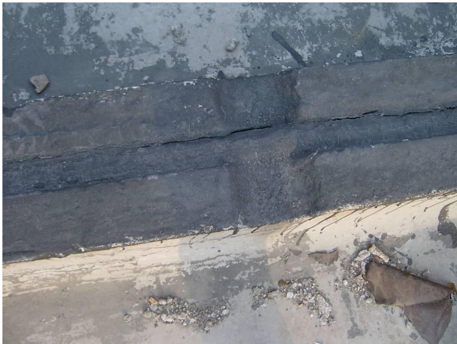
На снимке зафиксировано техническое состояние стыка железобетонных кровельных панелей. Разрушено гидроизоляционное покрытие
