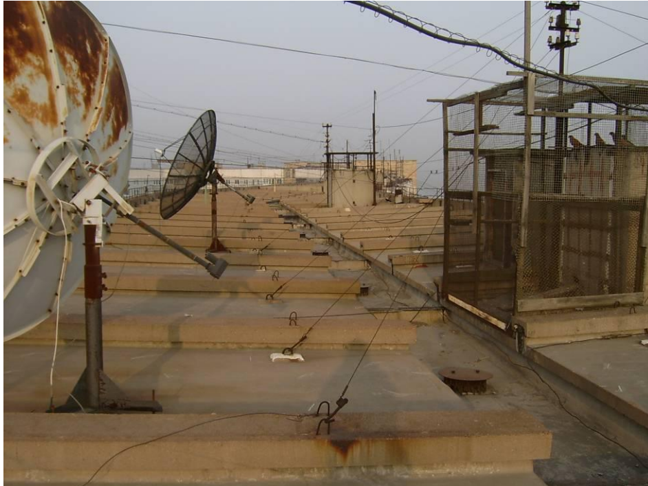
На снимке зафиксировано техническое состояние кровли основных секций жилого дома
