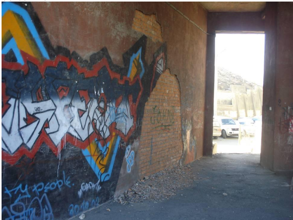
На снимке зафиксировано техническое состояние стен в пространстве арки (кирпичная вставка между основными секциями) – разрушение кирпичной кладки, штукатурного и окрасочного покрытия стен
