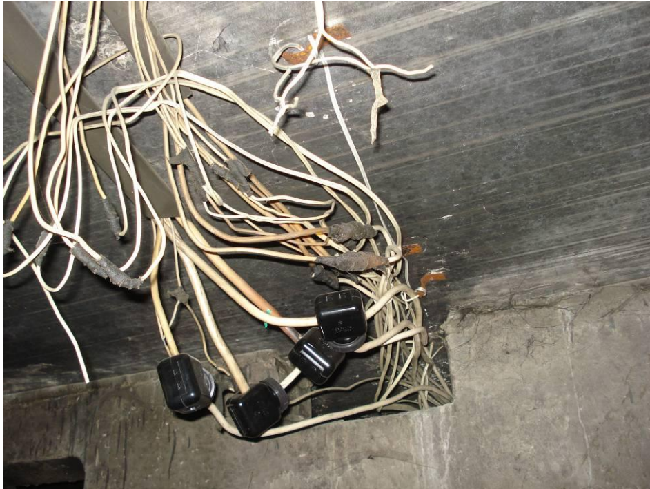
На снимке зафиксировано техническое состояние электропроводки в подвальном помещении
