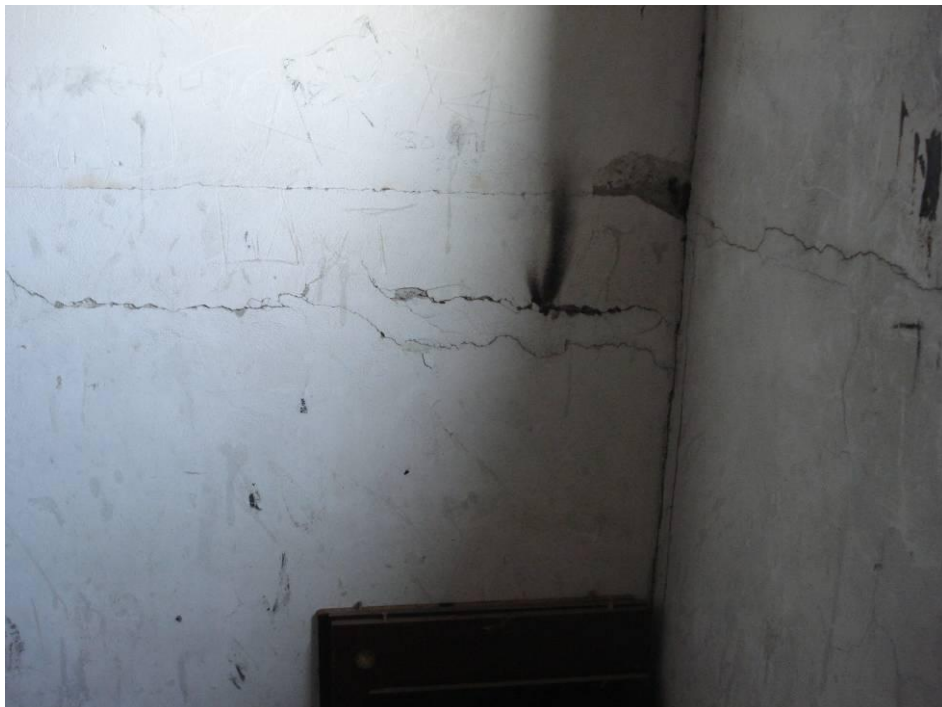
На снимке зафиксировано техническое состояние элементов внутренней отделки помещений лестничной клетки
